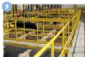
9 추락방지시설 (안전난간, 방벽, 개구부덮개, 미동식 시다리 등)
